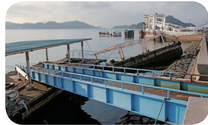
破損した宇野港浮桟橋
