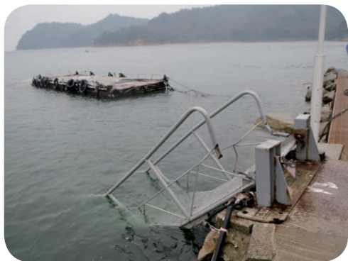
損壊した連絡橋
