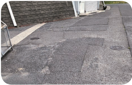
数センチもの段差でキケン
